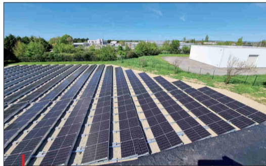
La centrale solaire au sol couvre 40% des besoins énergétiques de l'usine.
